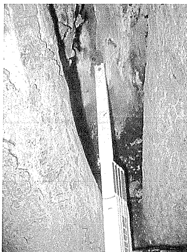
Faulhöhle am rechten Stämmling – die Faulhöhle ist 25 cm tief
