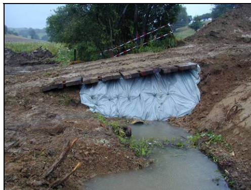
Abbildung 4: Wegequerung Herschbach mit Sicherung des Oberbodens gegen Abrutschen bzw. Ausspülung.
