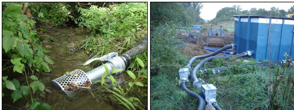
Abbildung 5: Filterkorb an der Wasserentnahmestelle (links) und Filtercontainer mit zwei flexiblen Auslaufrohren (rechts).
