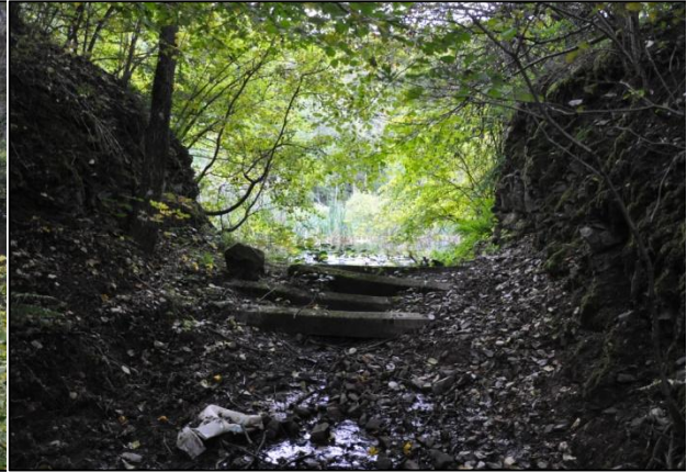
Foto 14: mit Eisenbahn-Betonschwellen gegen Tiefenerosion geschützter Auslauf
