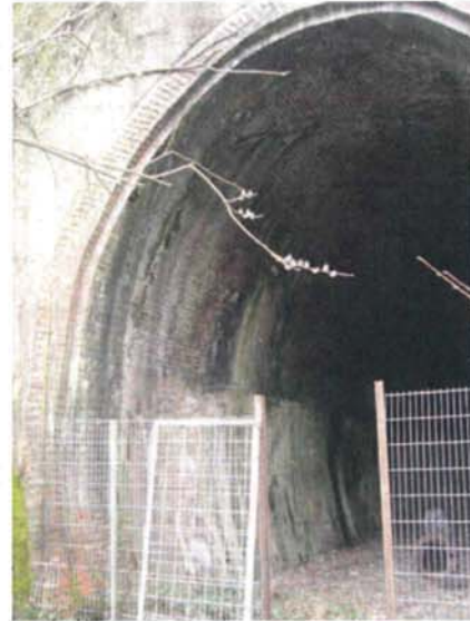
Abb.2: Eingang West (Biringen) des Tunnels. Deutlich sichtbar die zerstörten Absperrgitter.
