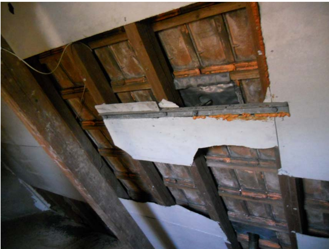
Abb. 2: Gipskartonplatten unter dem Ziegeldach; die Mausohren hängen zwischen Platten und Ziegeln. Foto: D. Gerber, 2011
