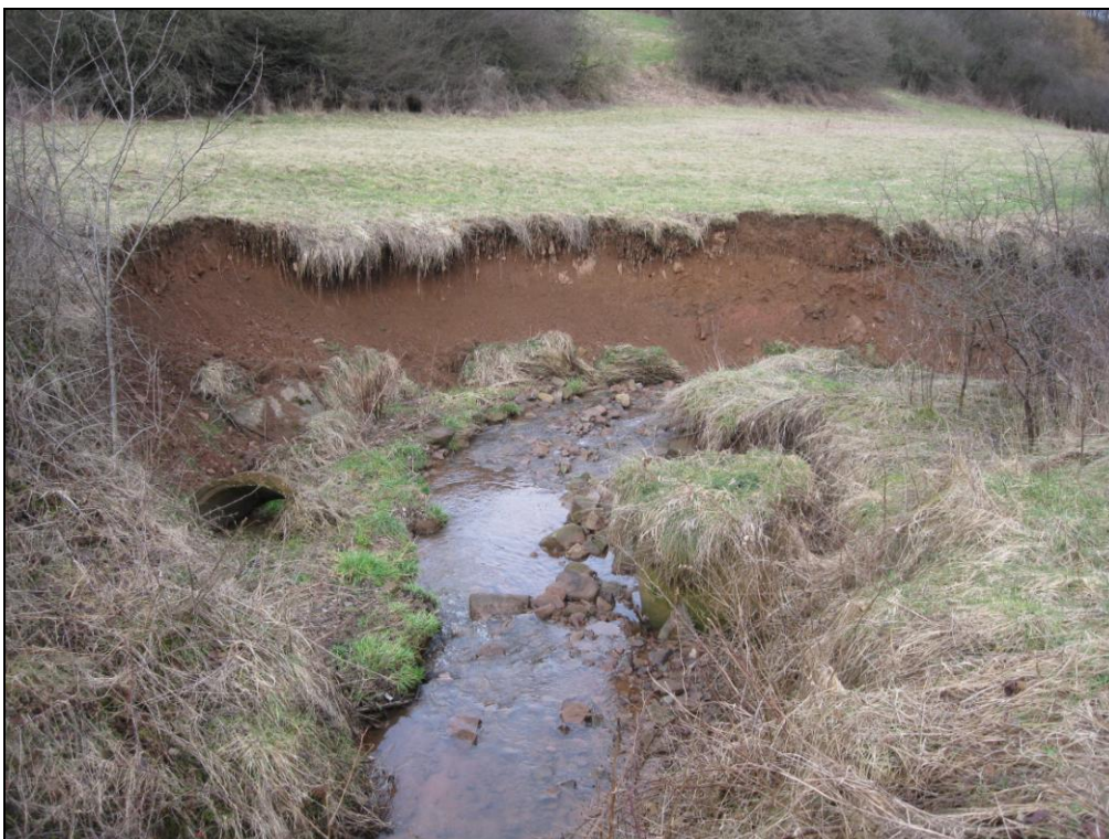
Merch, starke Erosion am Oberlauf
