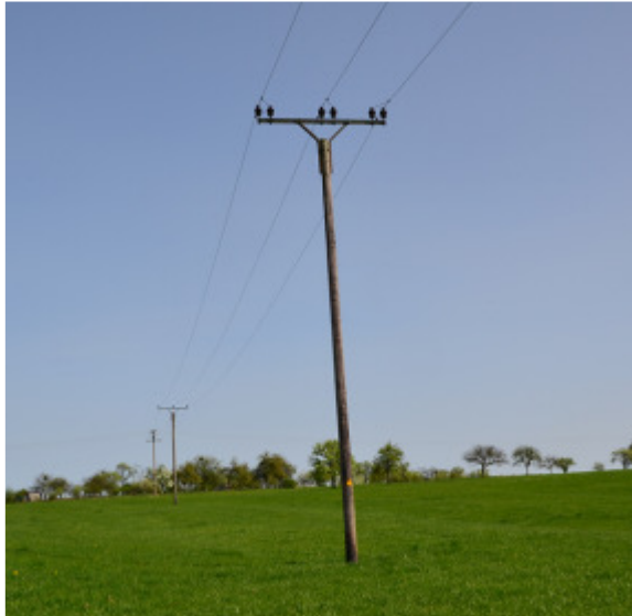
Ungesicherte Masten einer Freileitung zwischen Gerlfangen und Fürweiler (Mai 2010)
