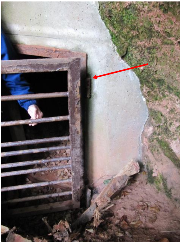
Abb.2: Gittertür des Stollens Eichelscheidt mit abgerissenem Scharnier Foto: D. Gerber
