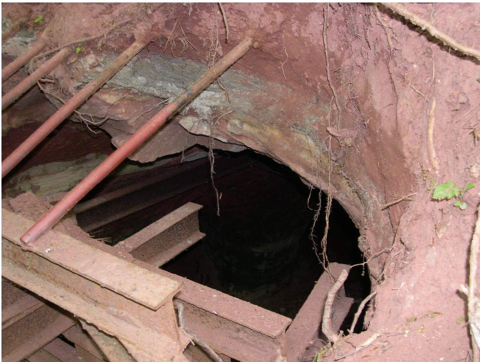
Abb. 2.: Schäden oberhalb des Gitters am Eingang A durch Erosion Foto: C. Harbusch, April 2011
