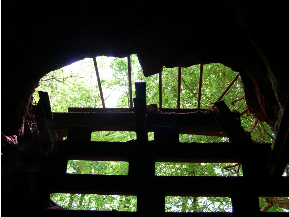
Abb. 3: Schäden am Eingang A von innen betrachtet Foto: C. Harbusch, April 2011
